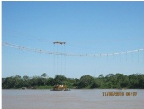
Octubre (Ing. Julio Pareja, FENAMAD) Se empezó a montar la estructura colgante
